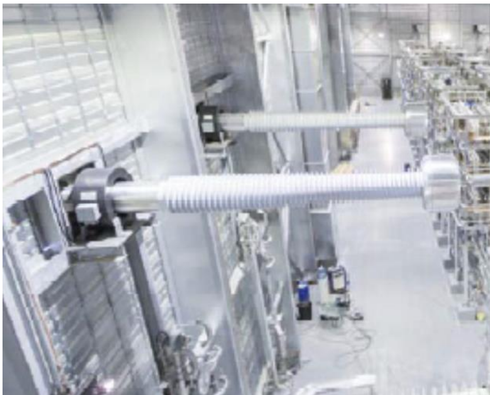
VKL gennemføring ventilhal/reaktorhal (strømtransformere)
